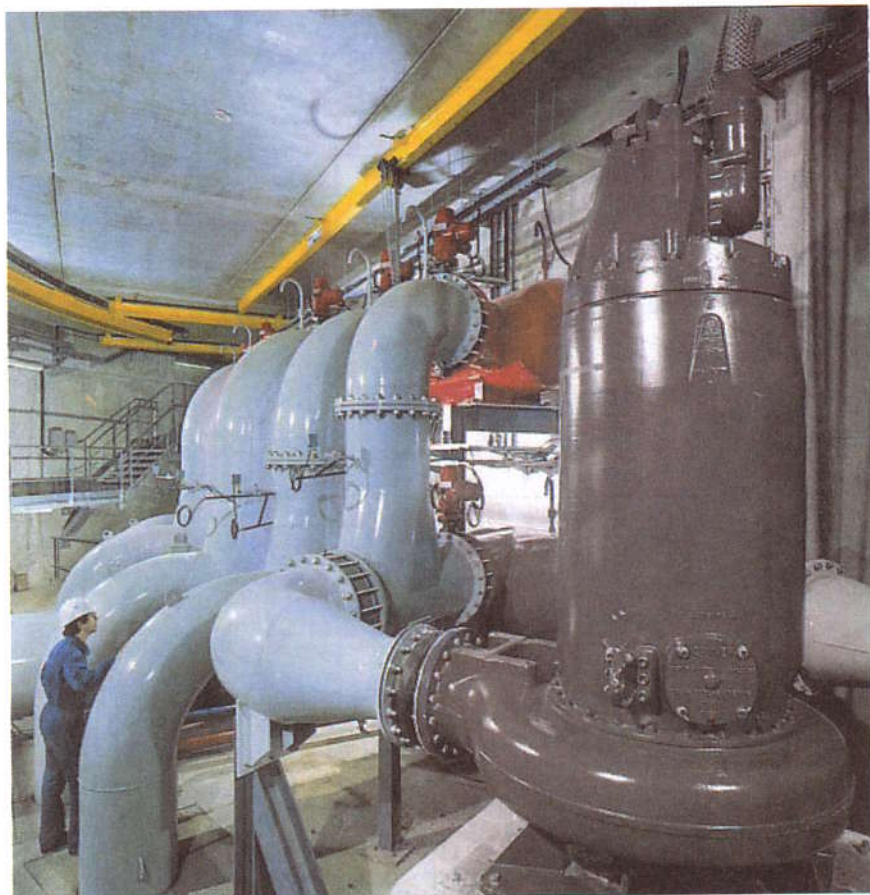
Рис. 5.36. Насосная станция «Аустерлиц»
