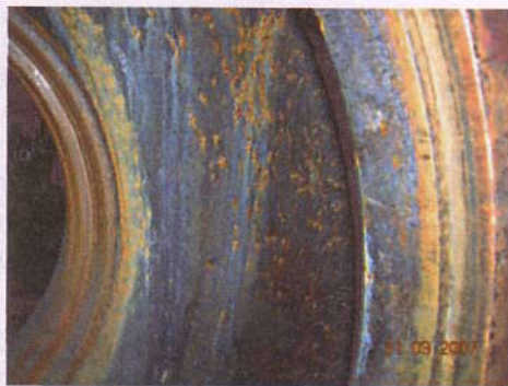
Рис. 4.1. Кавитация улитки после года работы насоса
